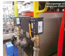
Heizungstechnik mit installiertem ECOJET
