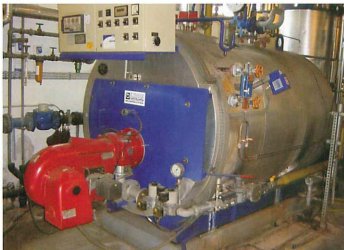
Die Heizungsanlage der Frierss Ges.m.b.H. wurde mit dem Ecojet System ausgerüstet
