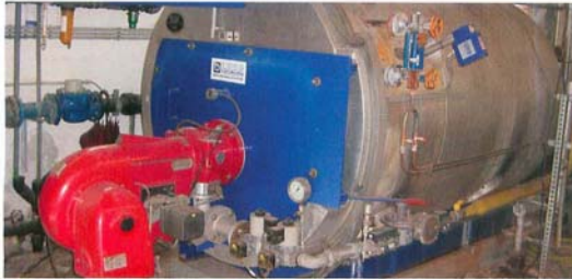
Durch den Einbau des Ecojet-Systems konnte der Energieverbrauch bei Frierss um 7,7 Prozent reduziert werden.
